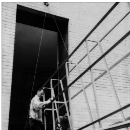
Het geraamte van de Noordzee-vitrine wordt aan de achterzijde van het gebouw naar binnen getakeld
